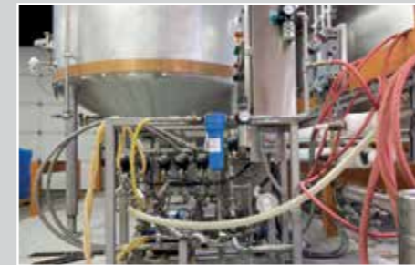
Flexible Verbindung durch Heizschlauch zwischen Tank und Produktionsanlagen. Temperaturerhaltung und Kompensation von Vibrationen entlang des Transportweges
