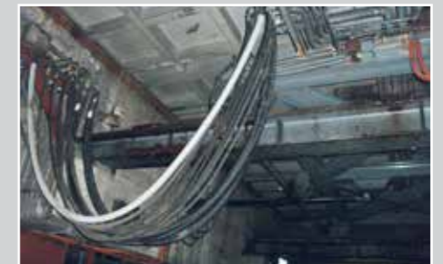
Heizschlauch (DN 50) zur Verbindung von Vorratsbehälter und Löschwasser-Verteilungssystem. Funktion: Frostschutz (+5°C) im Außenbereich. Mediumschlauch aus Polyethylen
